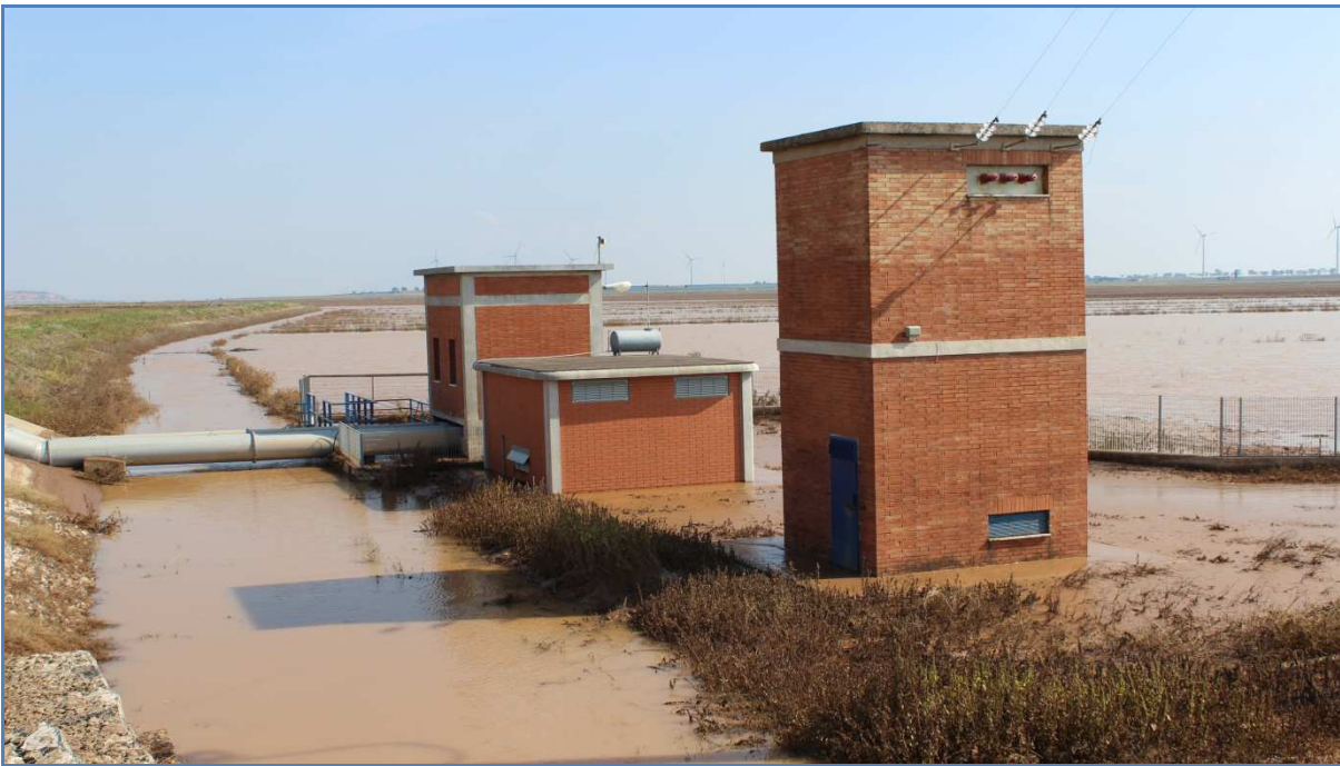
Danni agli impianti di sollevamento dovuti all'esonazione del t. Candelaro
